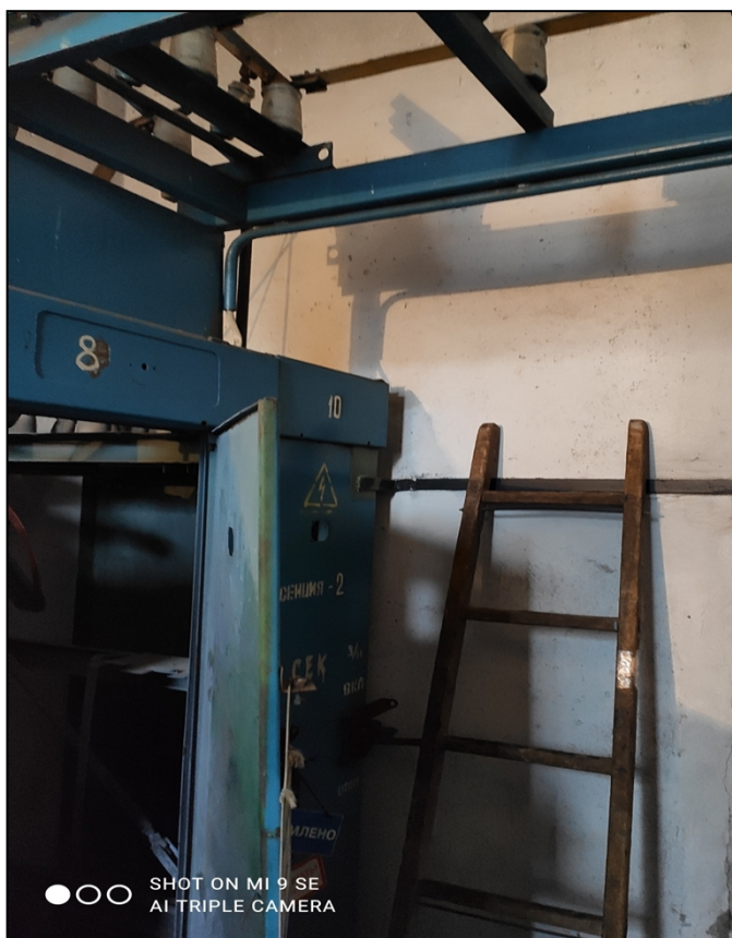
Место происшествия: шинный мост, приставная деревянная лестница
